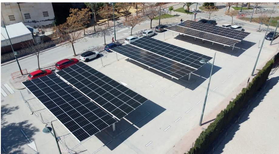
Parking fotovoltaico de 96 kW de la comunidad energética Comptem de Crevillent (Alicante)
