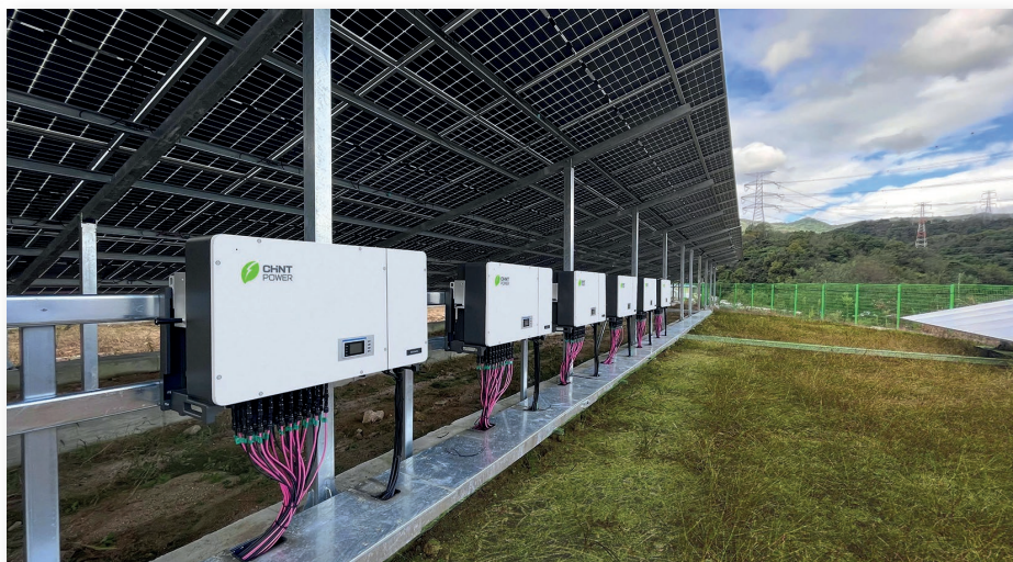
Planta fotovoltaica de 750 kW en Corea del Sur. El modelo de inversor utilizado es el Chint serie CPS SCA 125KTL-DO. Entre sus virtudes, permite un fuerte control de temperatura, lo que hace que no disminuya su potencia de salida hasta los 45°C. El diseño de la pantalla es único para el mercado coreano
