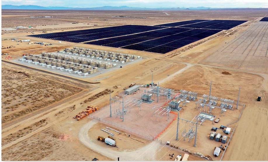
Las instalaciones de almacenamiento de energía y energía solar de Edwards & Sanborn están ubicadas en una antigua base de la Fuerza Aérea en California. La central eléctrica se extiende sobre 1.800 hectáreas de terreno y comprende 1,9 millones de paneles First Solar y 875 MW de capacidad de generación y casi 3,3 GWh de almacenamiento
