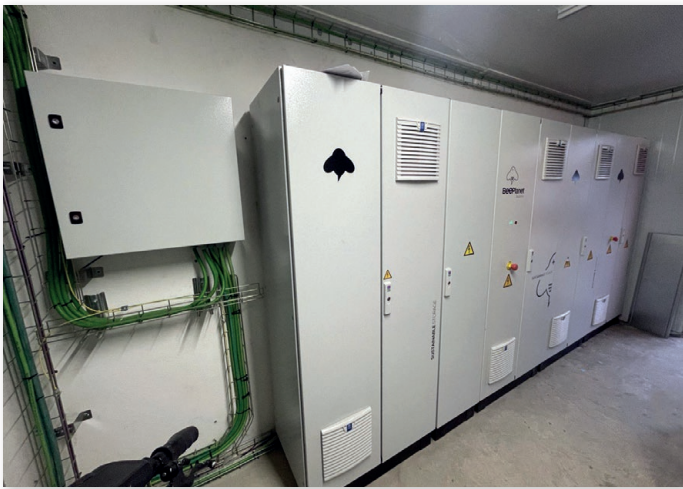
La instalación realizada en la estación de servicio Cepsa en Zaragoza cuenta con una potencia fotovoltaica de 159 kW y un sistema de acumulación de 126 kWh.
