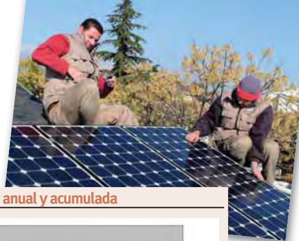
Las pérdidas acumuladas son de casi 2.000 euros, según la contabilidad real de la instalación analizada. Recortar durante tres años un 30% la prima por producción retrasaría el retorno de la inversión, algo insostenible para una economía familiar.
