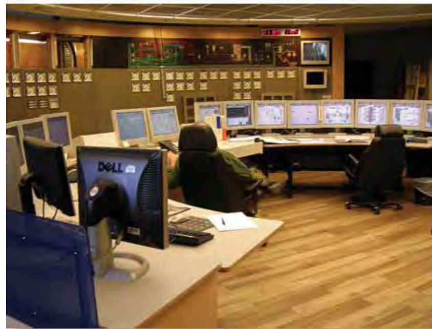
Central de mando de la planta de Sandvik
