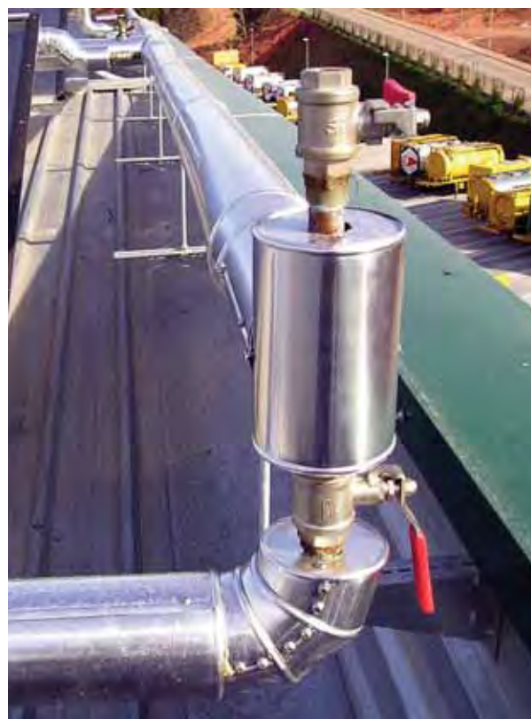
Durante sus diez años de vida, Aiguasol ha instalado sistemas solares térmicos en más de 3.500 viviendas. Además, en el ámbito de la industria, la empresa catalana lleva a cabo auditorías energéticas, actúa en el diseño, integración y optimización de procesos industriales y, por supuesto, también instala sistemas solares térmicos.
