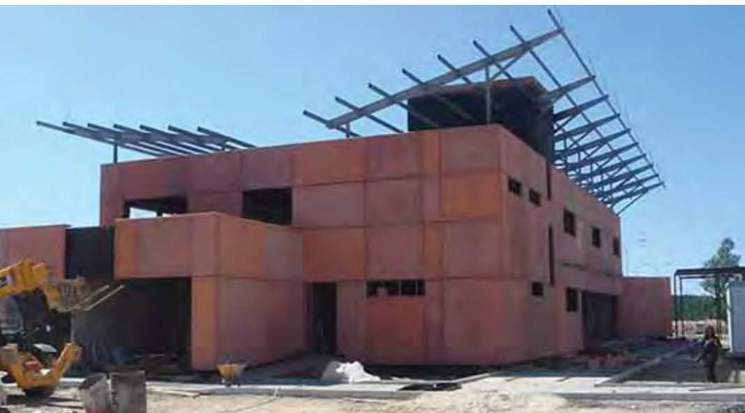
El edificio del Centro de Control y Accesos del Centro de Desarrollo de Energías Renovables (CEDER). En la página siguiente, arriba, el Centro de Investigaciones en Energía Solar (CIESOL); Rosario Heras, coordinadora del área de Eficiencia Energética del Ciemat y responsable del proyecto y, abajo, el edificio de la Fundación Barredo.
