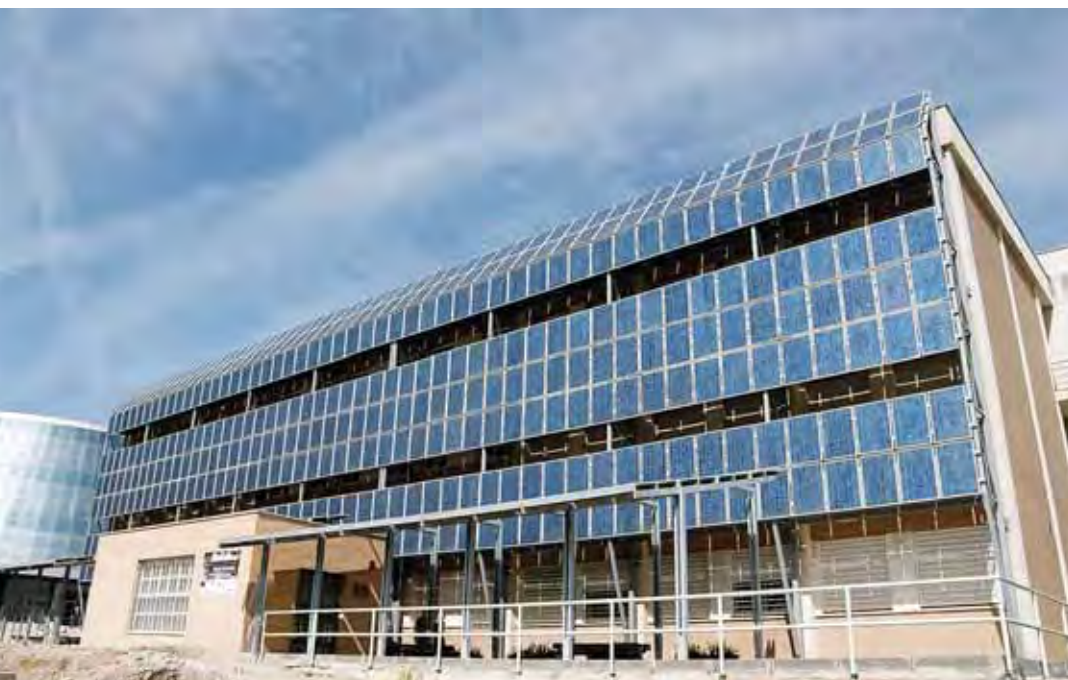
Instalación fotovoltaica de la Universidad de Jaén.
