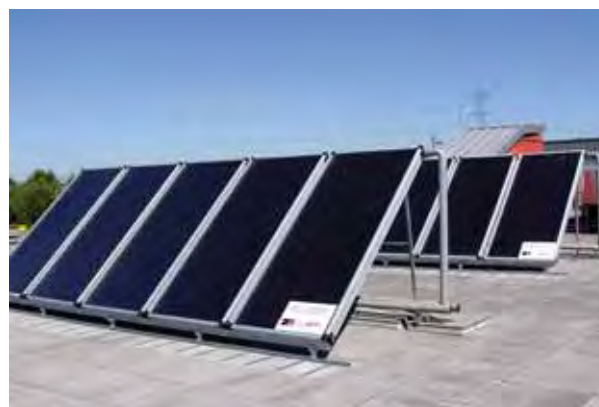
Detalle de la instalación solar térmica de la Universidad de Madrid, cuya ejecución fue posible gracias a un programa de apoyo a este tipo de iniciativas que ha puesto en marcha la Fundación Caja Navarra.
