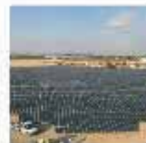
Planta fotovoltaica en Murcia
