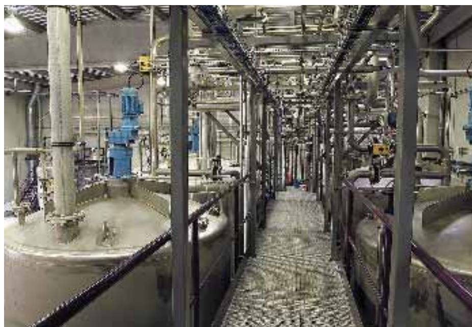
Planta de biodiésel de Stocks del Vallés. Situada en Montmeló (Barcelona), inició su producción en 2002. Actualmente tiene una capacidad de 31.000 toneladas anuales.
