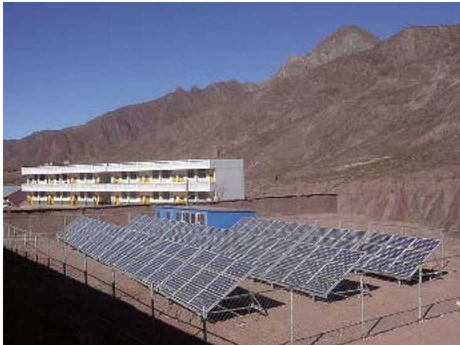
Proyecto rural en el Tibet de 25 kW de potencia. La foto es de Trina Solar.
