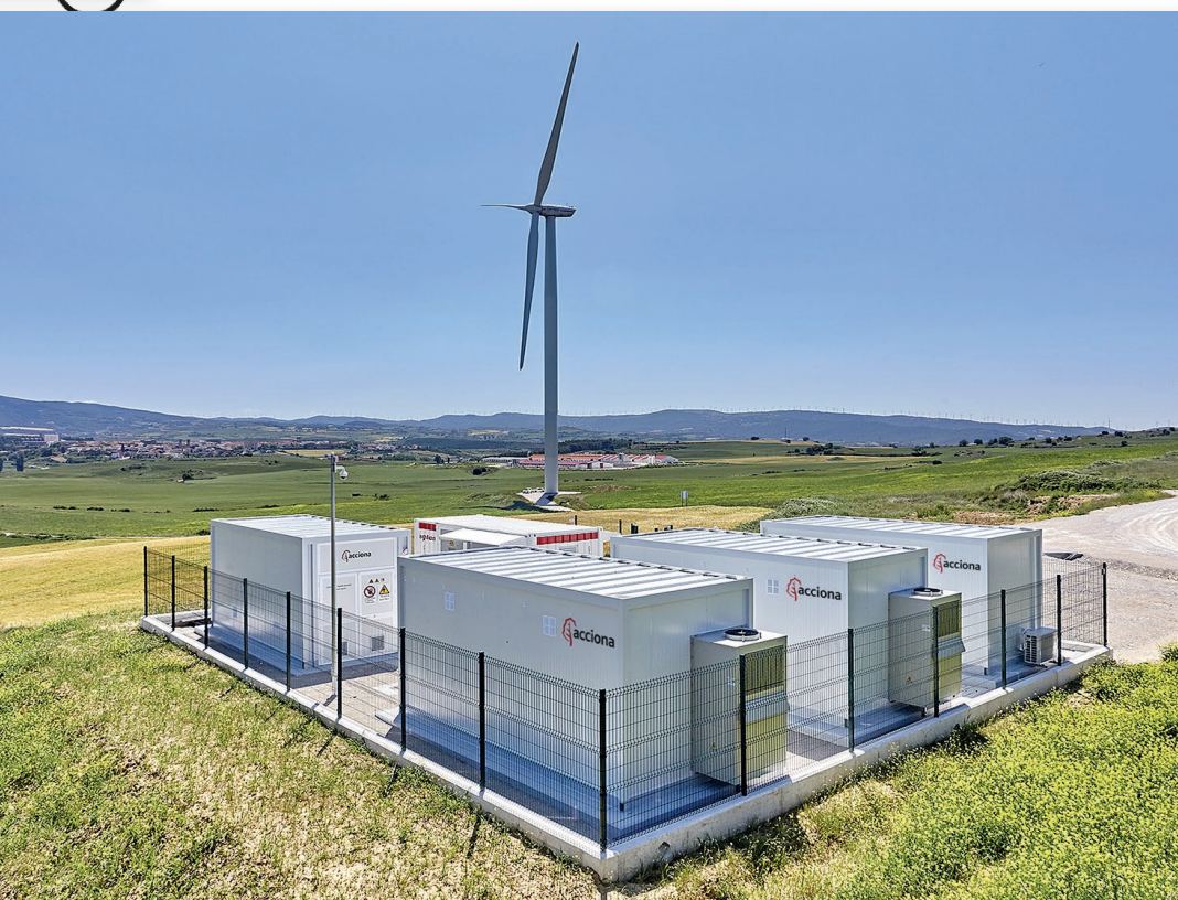
Planta híbrida de almacenamiento de electricidad en baterías integrada en un parque eólico de Acciona Energía en Barásain (Navarra) conectado a la red en España. Debajo, sistema de volantes de inercia KINEXT, de S4 Energy.
