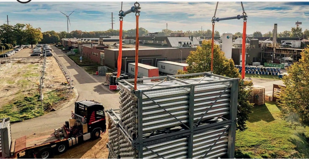
Las unidades de almacenamiento térmico de Energynest se han instalado en la futura plataforma CST más grande de Europa para alimentar la fábrica de adhesivos de Avery Dennisons en Turnhout, Bélgica
